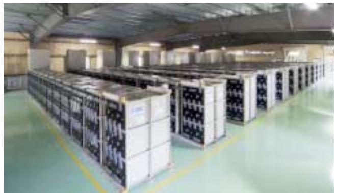
図7 市浦風力発電所の建屋内に設置された蓄電池ユニット外観
