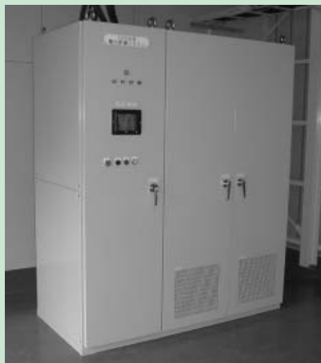
100kWシステム
