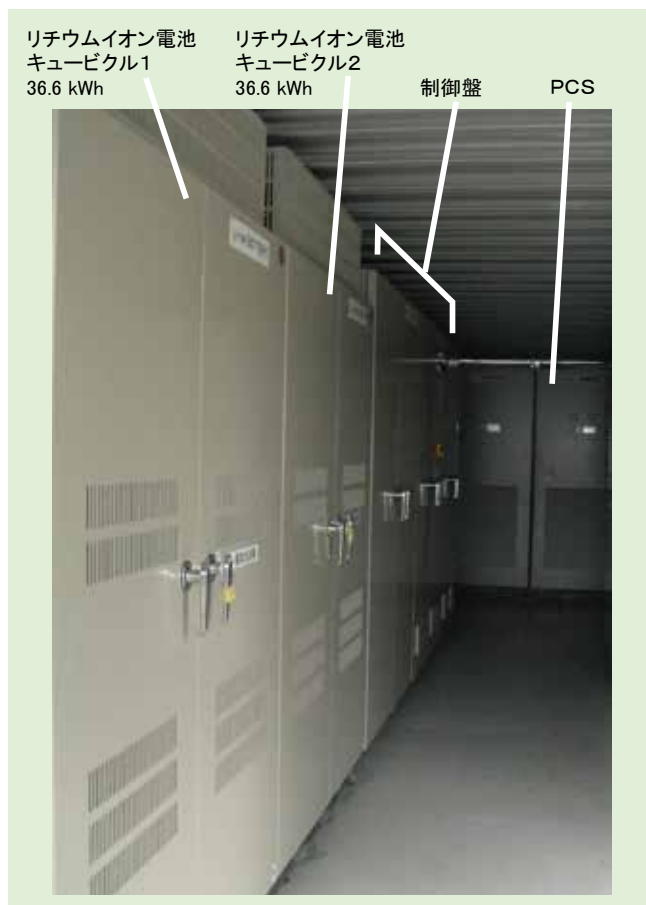
図6 リチウムイオン蓄電システム外観 Fig.6 Over-view of Li-ion battery system
